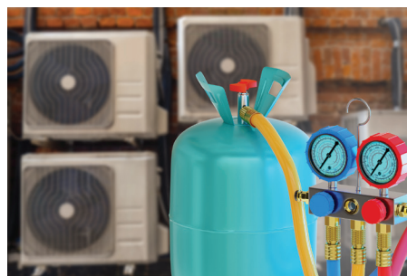
Vérification de la pression du gaz
