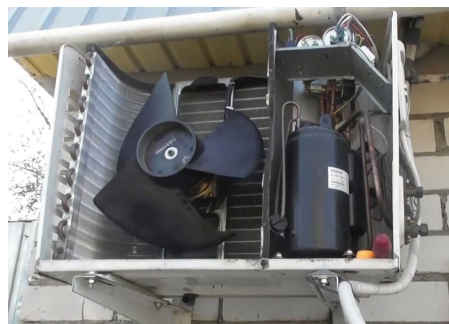
Échangeur et compresseur
